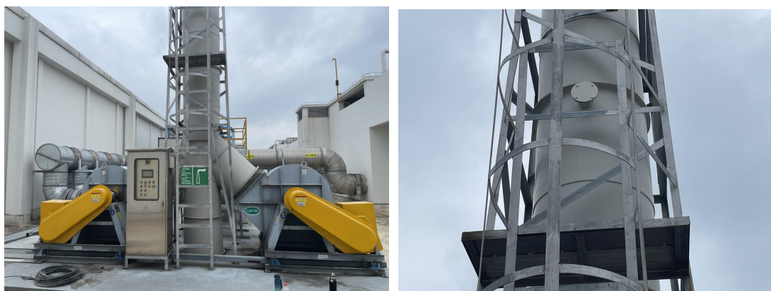
图 4-3 酸碱喷淋塔废气处理设施及进出口采样点位
